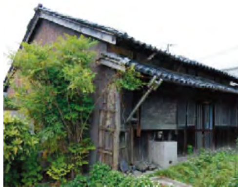
改修前：屋根が垂むほど老朽化が進んでいた
