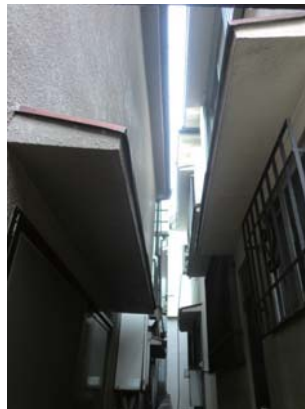
隣地との空気がほとんどない状況。
