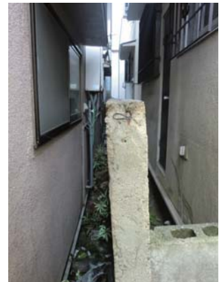
隣地境界のブロックが傾いて人が入れない状況。
